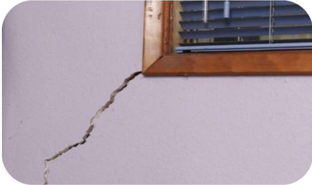
Dommages sur nos infrastructures
